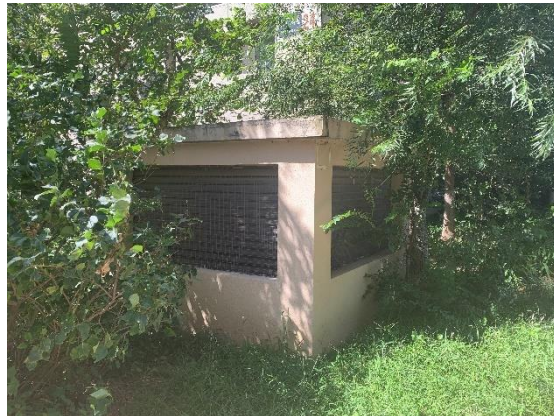
158 地块排风竖井 (4)
